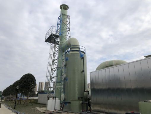
除臭装置+排气筒
